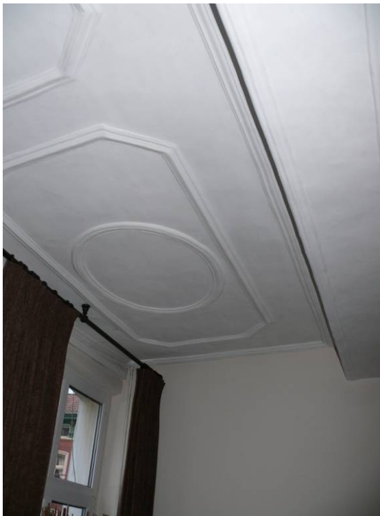
Gasthuisstraat 5, stucplafond eerste verdieping
