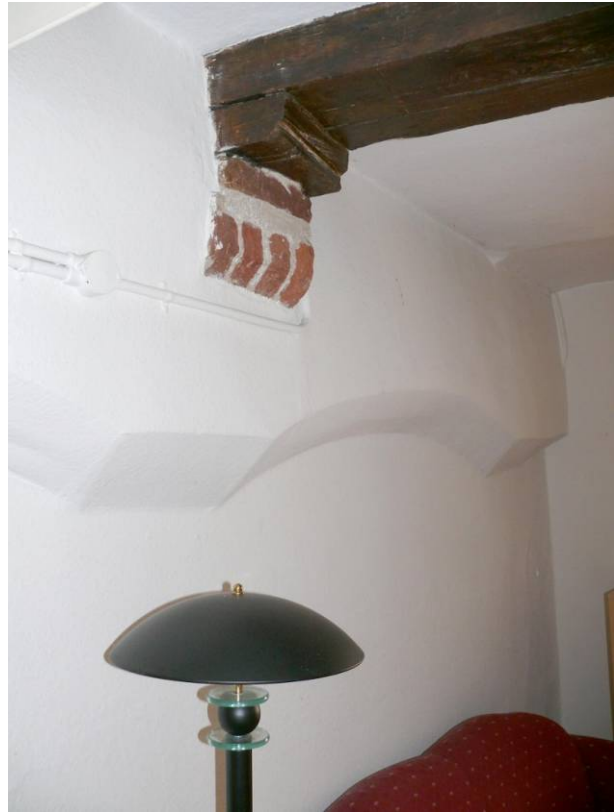
Spaanrissen met afgehakte muurdammen in de oostgevel van de eerste verdieping
