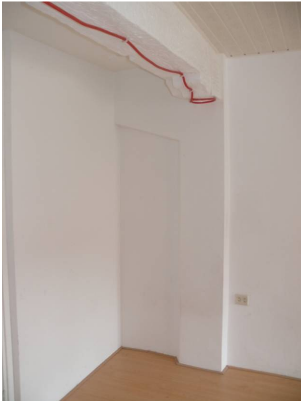
Spaarnis in de westelijke gevel op de tweede verdieping
