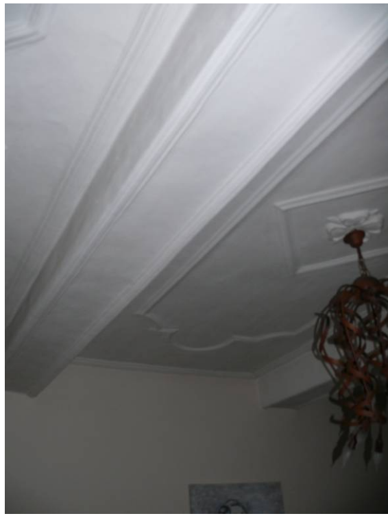
Nr.5, centrale balkvak stucplafond eerste verdieping
