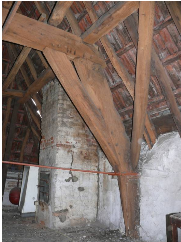
Geknikt spantbeen van het kapsant
